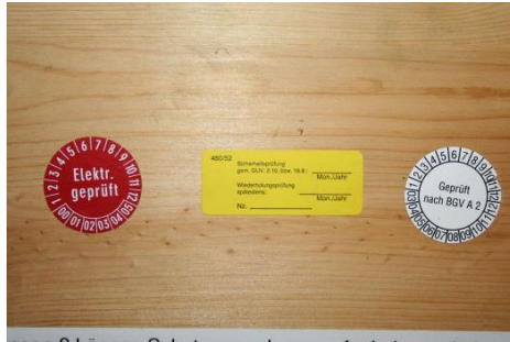
Kennzeichnung von überprüften elektrischen Betriebsmitteln
